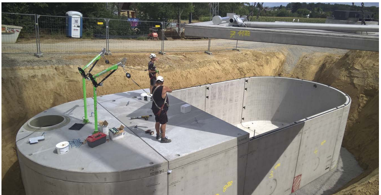
Abb. 13.1: Betonbehälter als Löschwasserbehälter
